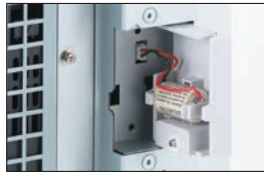
リチウム電池交換
